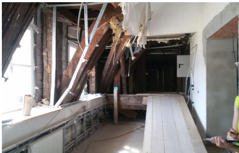
Abbildung 6: Das problematische Zugband im AA-Trakt (unter der Rampe)
