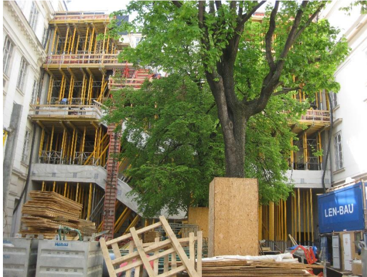
Abbildung 3: Der Baustellenbereich muss gegen Eindringen von Unbefugten gesichert werden
